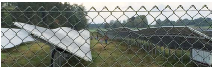
Unbefugte (Familie mit Kindern) laufen im Solarfeld umher ohne zu wissen, welche Gefahren dort lauern.
